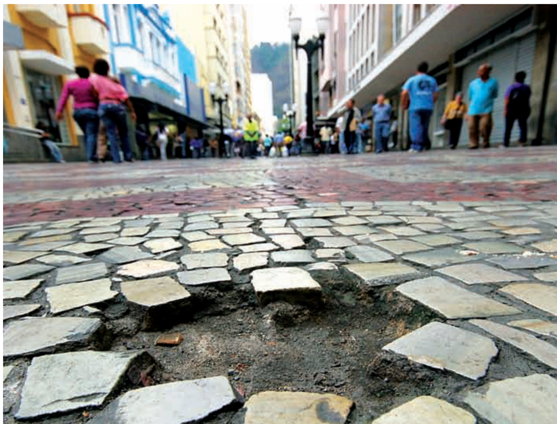
Buracos nas calçadas são problemas em vários bairros; no Centro, as pedras portuguesas são alvo de críticas; projeto da PJF prevê a padronização das calçadas. Página 4
